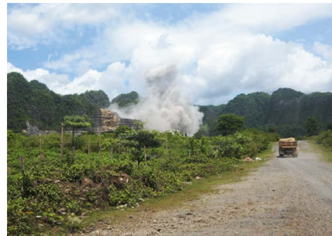
Kontrollierte Sprengung von Karststein zur Gewinnung des Rohmaterials für die Zementproduktion im Bosowa-Zementwerk. Die Erschütterung der Explosion ist bis in die umliegende Wohngegend zu spüren und hat die Kraft, Fenster und Geschirr zerspringen zu lassen. Maros, 14. Dezember 2018.
